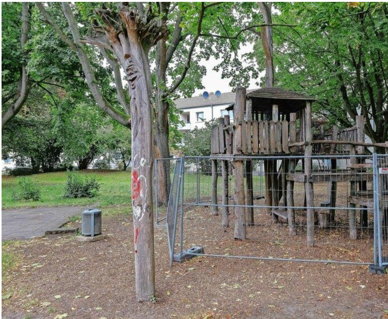
Die marode Holzkonstruktion auf dem Spielplatz in Vahrenheide wird ersetzt. Foto: Tim Schaarschmidt
